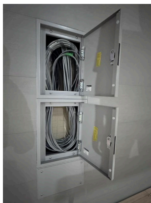
北側のケーブルボックス(主コネクタパネル設置位置)
